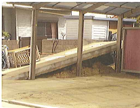
写真)液状化による隆起。もともとは平な道だった。
